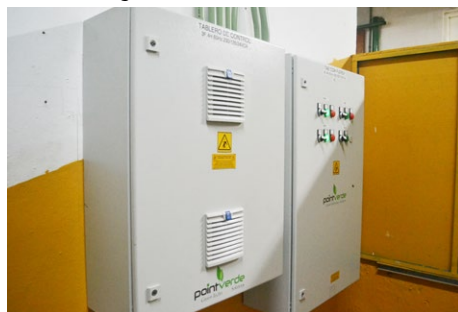
Sistema de Gestión de las Calderas de Alta Eficiencia
