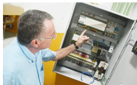
A través de este sistema, se controla la producción de agua caliente sanitaria de Palmar 1 y 2 de Oasis Cancún
